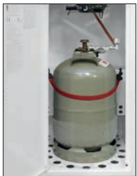
Einsicht in geöffneten Sockel mit angeschlossener Gasflasche
